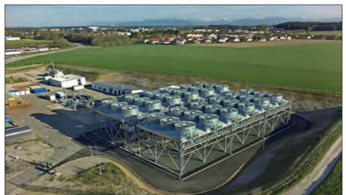
Abb. 8: Geothermieheizkraftwerk Traunreut (im Hintergrund die Stadt)
