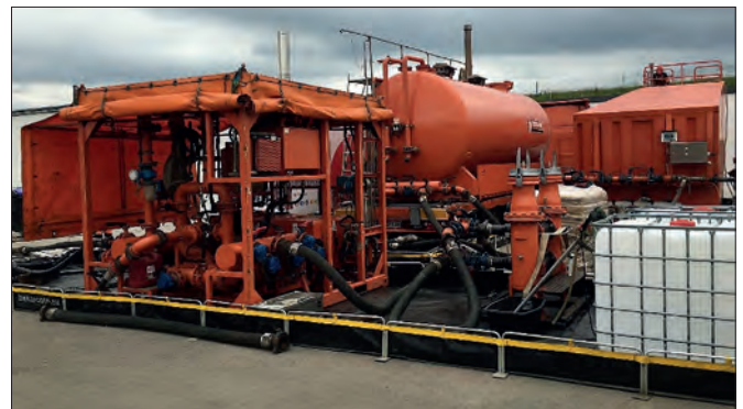
Abb. 7: Teil der Reinigungsanlage für den Thermalwasserkreislauf eines oberbayerischen Geothermieprojekts mit einer starken organischen Säure
