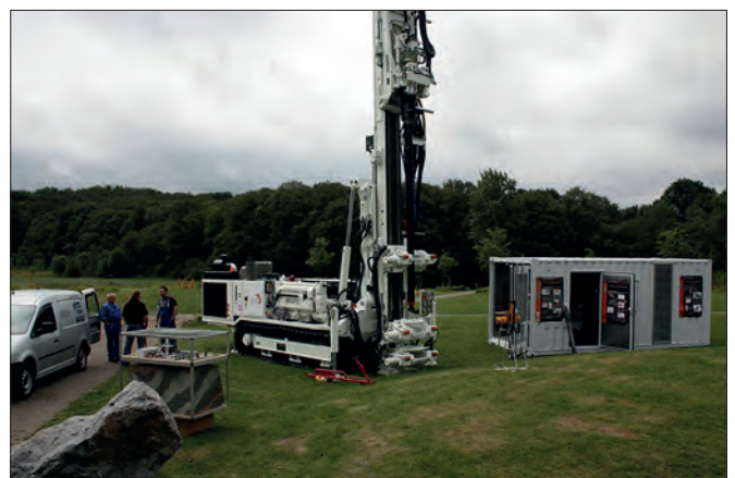
Abb. 2: Projekt LaserJetDrilling des Internationalen Geothermiezentrums Bochum (GZB); rechts neben der GZB-Bohranlage BO.REX steht die von Kamat konzipierte Hochdruckstation (Foto: GZB)
