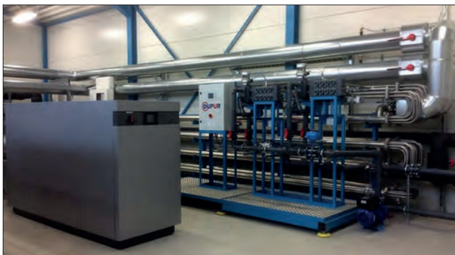
Abb. 10: 2. Bauabschnitt der geothermischen Sumpfungswassernutzung aus Braunkohlentagebauen für den Ertfverband mittels Wärmepumpe und eines Abwärmerückgewinnungssystems mit konstanter Heizleistung durch regelmäßiges Molchen
